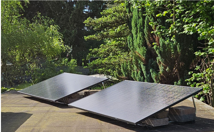
Abbildung 5: Beispiel für ein gefördertes Balkonkraftwerk in Recklinghausen, Quelle: Uwe Dräger, Recklinghausen
